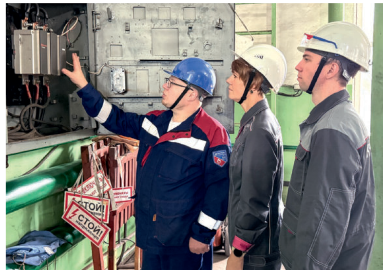
Шкаф управления испытательной станцией показывает комиссии начальник участка РЭМ энергослужбы Александр Кузнецов (слева).
