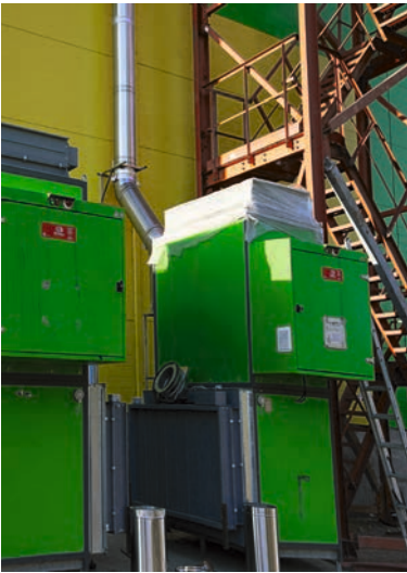
«Тепловей» мощностью от 170 до 300 кВт
